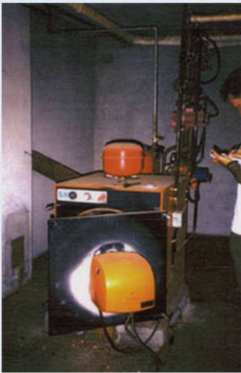
Generatore esistente prima dell'intervento
