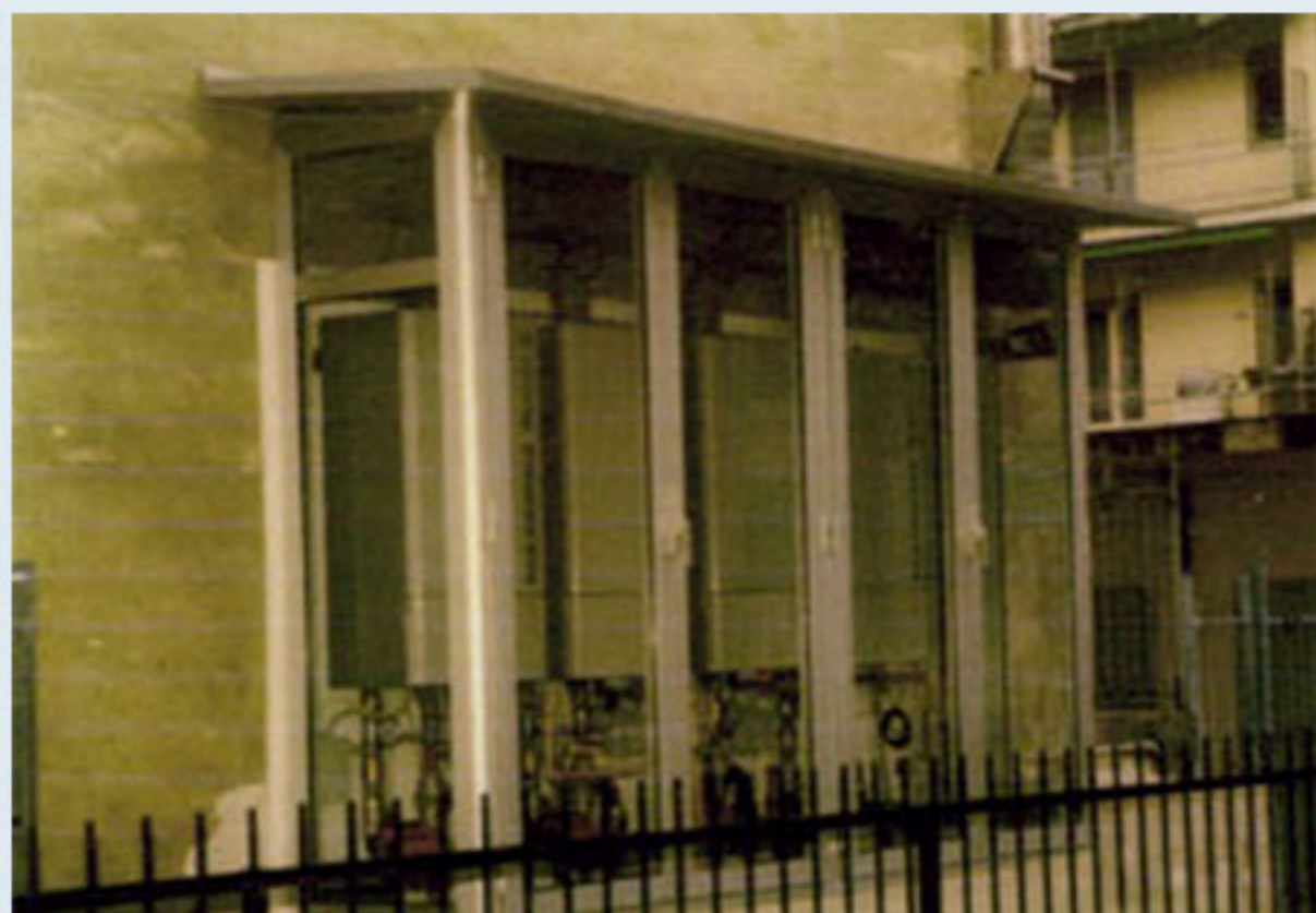
Dopo l'intervento (4 generatori in cascata)
