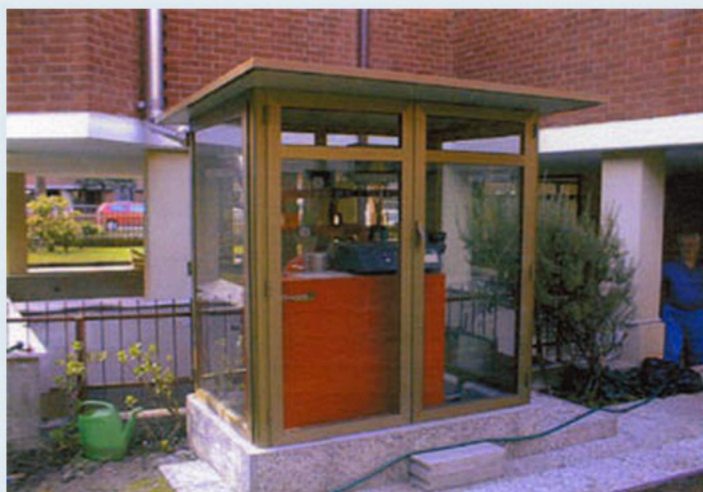
Generatore in cabina antisfondamento
